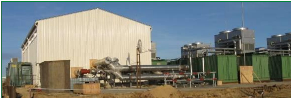
Рис. 2: Замораживающая станция Тиссен Шахтбау. Здание рассольных насосов и замораживающие агрегаты в контейнерном исполнении.
