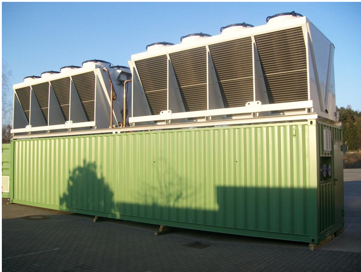
Замораживающая установка с конденсаторами, готова к эксплуатации.
