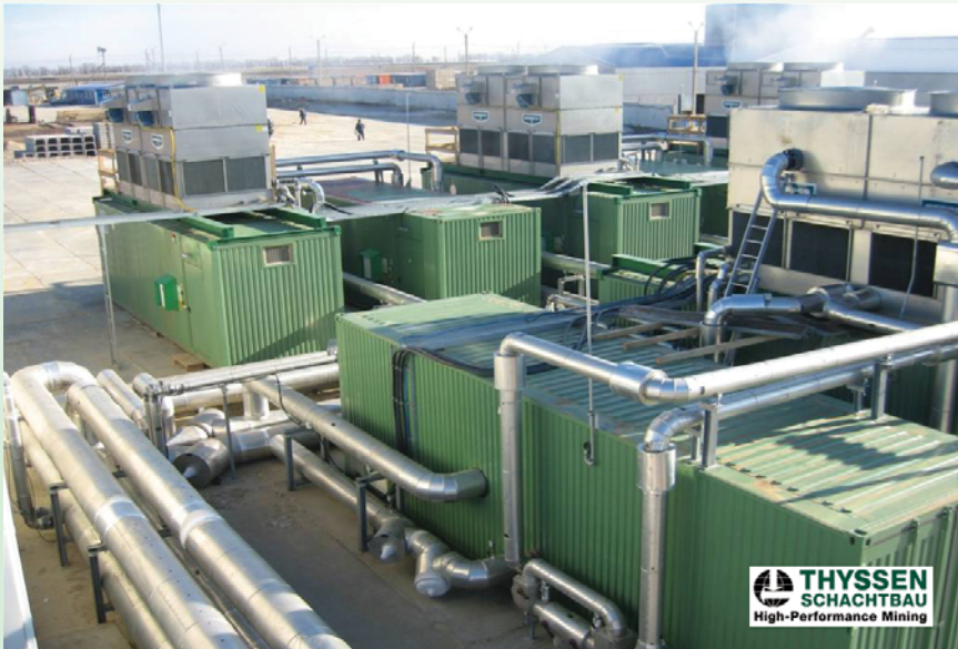
Замораживающая станция ТИССЕН ШАХТБАУ была введена в эксплуатацию через 4 месяца после окончания буровых работ
